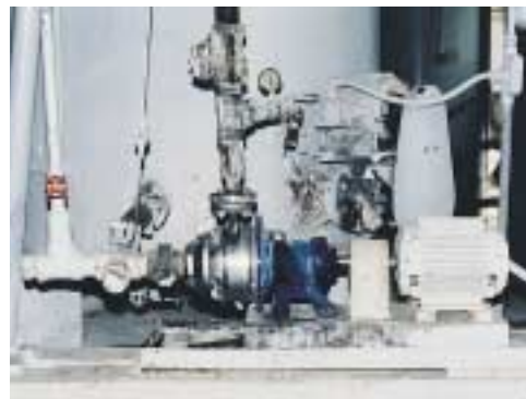
Boiler feed, Alimentación de caldera
